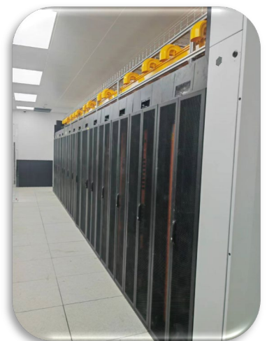
核心机房扩建区机柜
