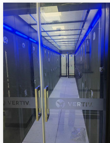
◁ 核心机房机柜通道 ▷
